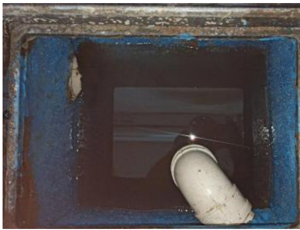
图 1 诊疗废水消毒池 (TW001)
